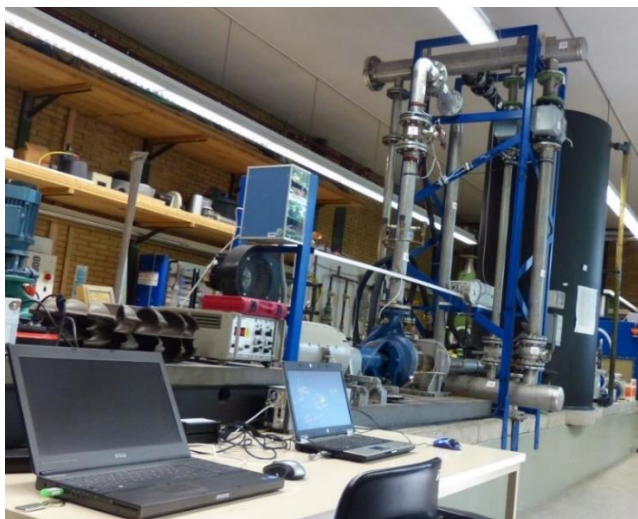
Widok stanowiska do badania emisji akustycznej podczas przepływu wody w instalacji wody słodkiej w THM
