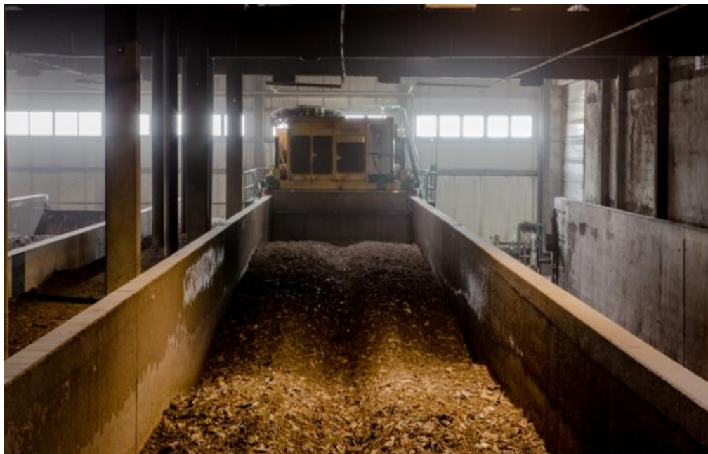
Rys. 2.10 Zbiornik z betonu, żelbetu i stali, w którym znajduje się kompost [172]
